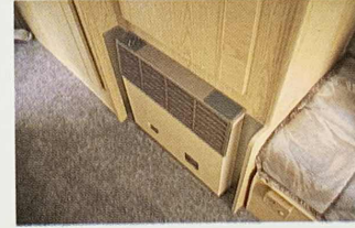
FFガスヒーター
